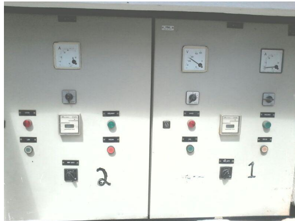
Figura 2: Vista de painel elétrico com horímetros do SES Ilhéus
